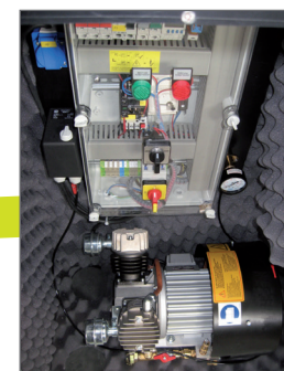
Stacja sprężonego powietrza ROMOLD
