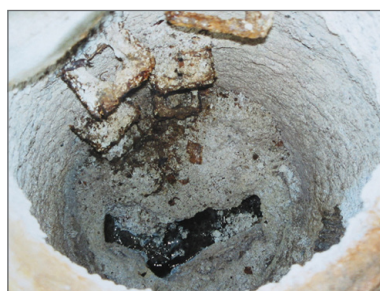
Skorodowana studnia betonowa
